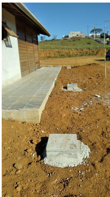
Figura 1: Caixas de esgoto instaladas
